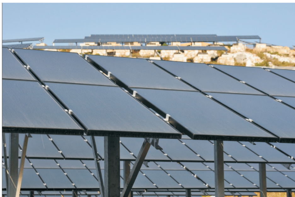
光伏坡地电站。
