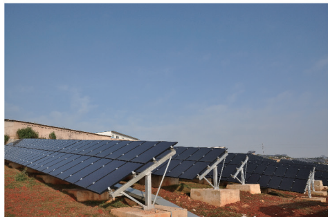
地面电站方阵一采用固定式支架系统，工期短，成本低，无耗能
